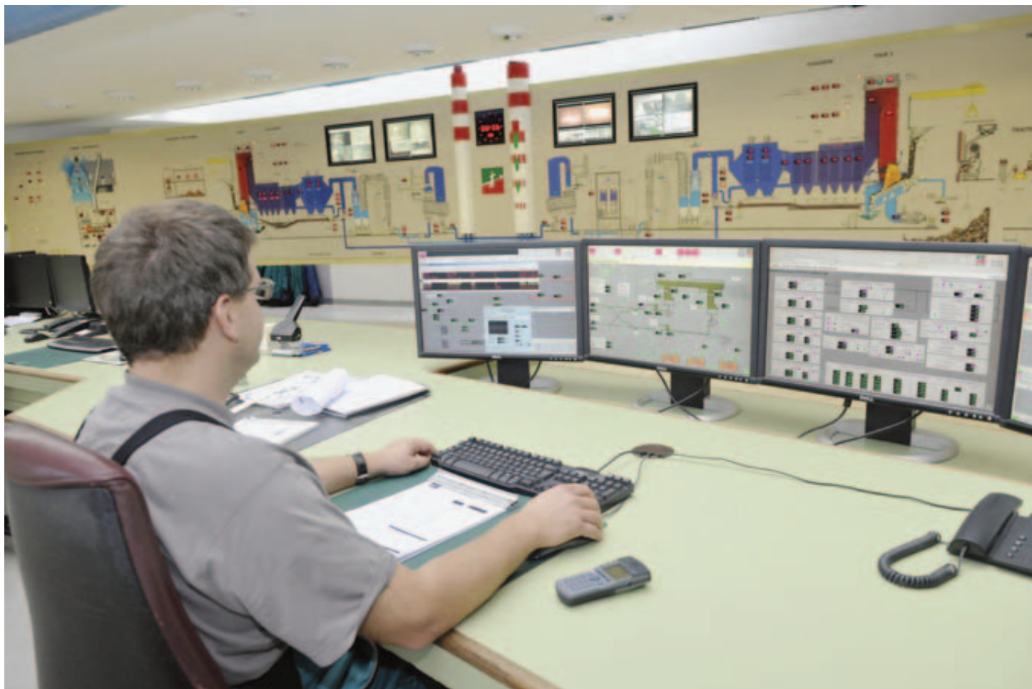
La SATOM est désormais saluée comme une pionnière grâce au réseau qu'elle a mis en place pour valoriser l'énergie dégagée par la combustion des déchets ménagers récoltés dans quelque 80 communes valaisannes et vaudoises. BITTEL
