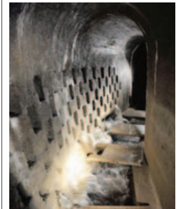
Les pouvoirs publics accordent une grande attention aux eaux de source captées (ici celles de Derborence). POT/A
