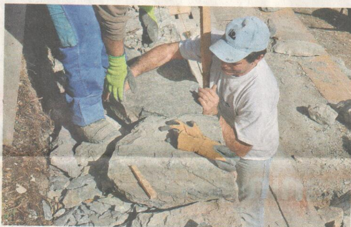
L'Etat du Valais a mis sur pied un plan de sauvegarde des murs en pierres sèches. J. MARGELISCH
